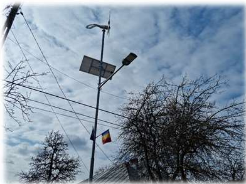
Stâlp alimentat cu energie solară
